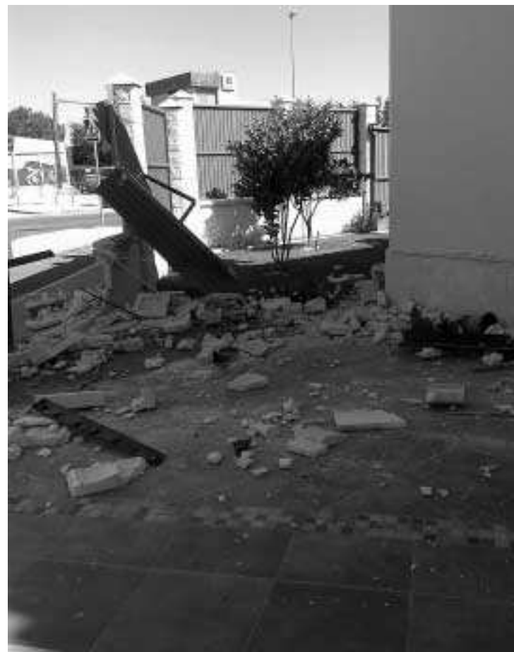
Destrozos en el patio de la vivienda.
